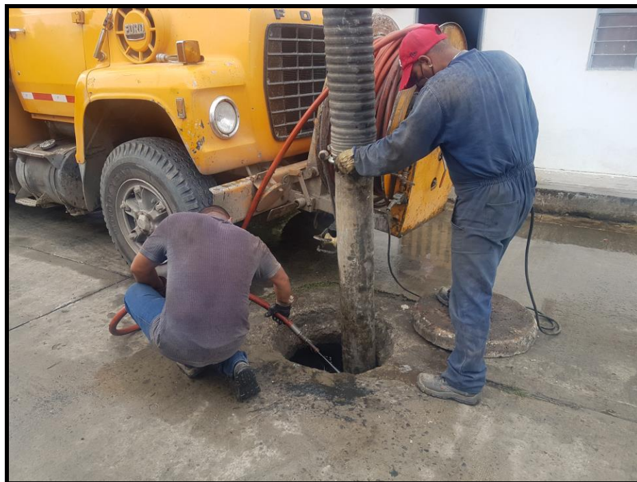
Mantenimiento de Redes de Alcantarillado con equipo lavado, presión, succión en Buchitolo
