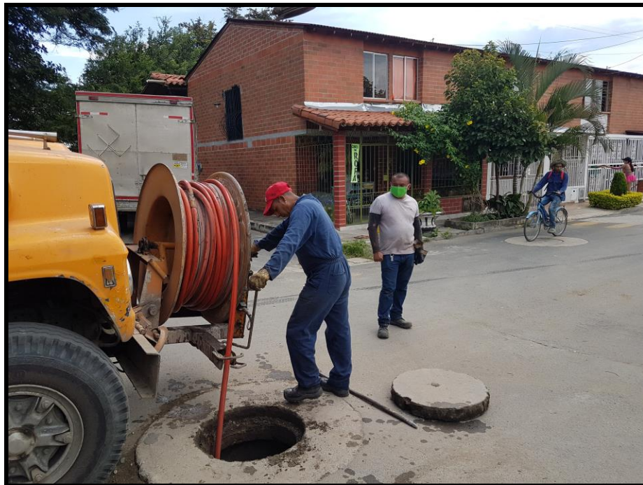
Mantenimiento de Redes de Alcantarillado con equipo de lavado, presión, succión en Villagorgona
