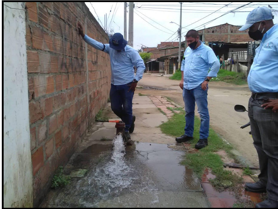
Puntos donde se realiza las purgas en el Corregimiento de El Carmelo
