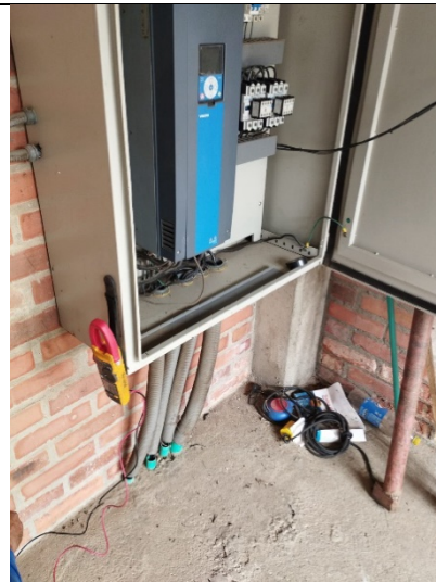
Mantenimiento preventivo de controles en la Estación de Bombeo en San Joaquín.
